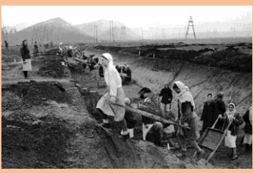
Строительство противотанковых рвов в районе Донбасса. УССР, 1 сентября 1941 г. Фото Б. Ярославцева Собрание МИА «Россия сегодня»
